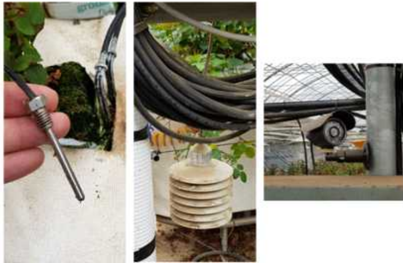
그림 148. 온실 내부에 설치된 환경 센서 및 CCTV
