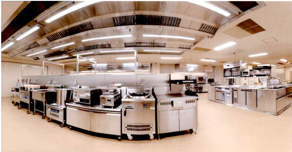
<오사카 전기주방연구소 엘텍신오사카 내부전경>
