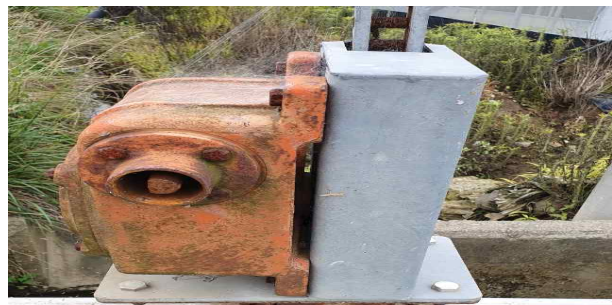
(b) 시설 관리가 안 되어 작동이 안 되는 현장
