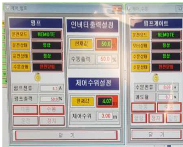
Fig. 210 펌프 및 수문 상태 및 제어창
