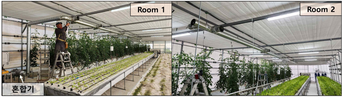
[내부 열공급 배관 구축(천정형 덕트)]
