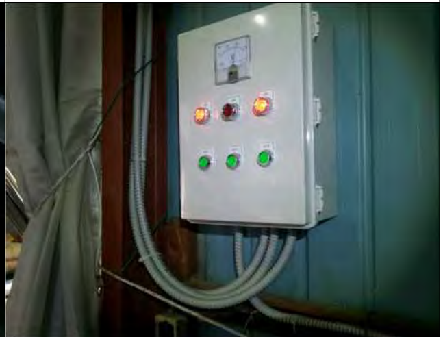
그림 7-57. 녹색WG 원료 정선시스템의 컨트롤박스 설치 모습
