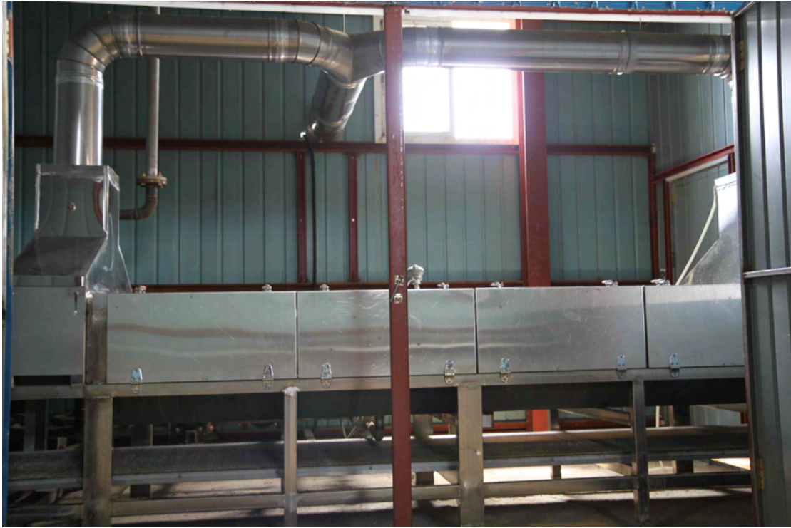
그림 7. 블랜칭 스팀 누출 방지 챔버 및 배기 pipe가 부착된 블랜칭부
