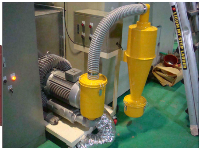
그림 7-30. 히터 현장 설치
