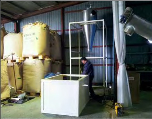
그림 7-54. 녹색WG 원료 정선시스템의 싸이크론 좌대 설치 모습.
