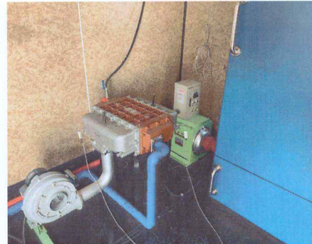
열교환기 유입/유출 온도 측정
