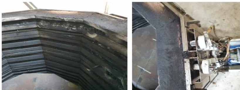
[오일연소 및 가스체류로 인한 열선 및 히터부 손상]
