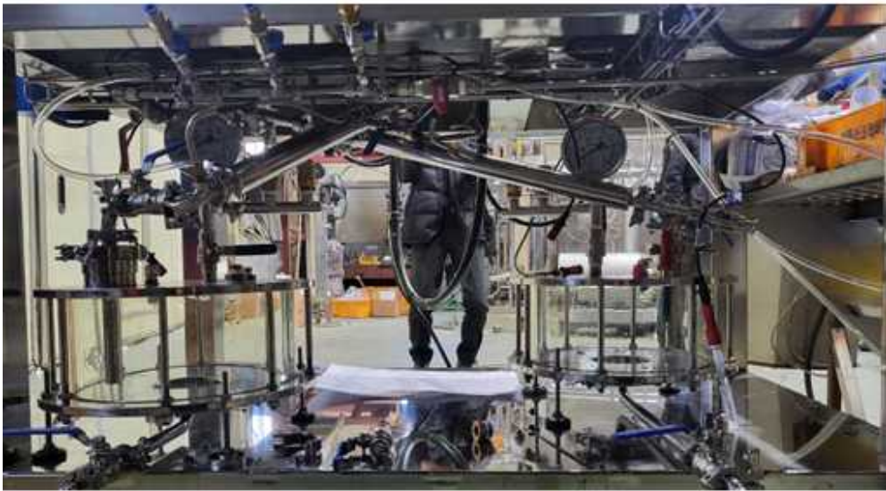
개선 후의 관 배열 전경.
