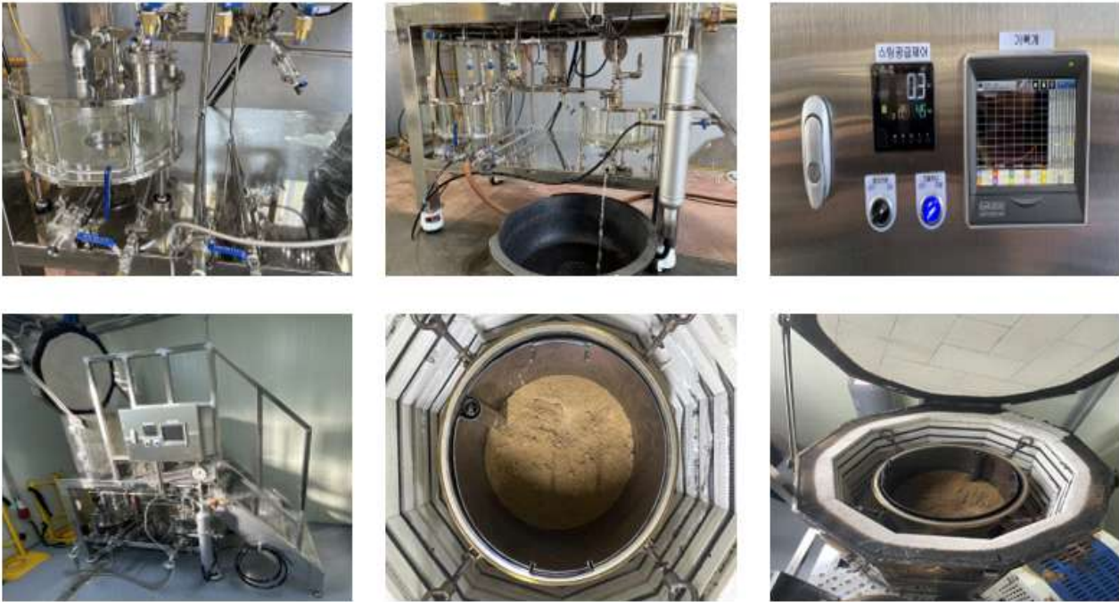
Fig. 77. 가축사체 전용 biochar 제조장치의 설치 및 시운전.
