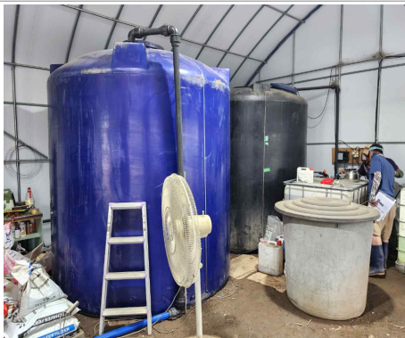
시설원에 농가의 여과액비 탱크 설치 모습
