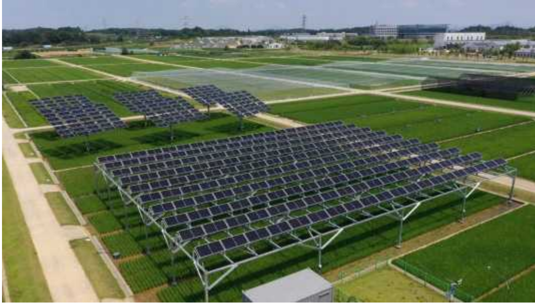
<국립식량과학원 내 구축된 영농형 태양광 설비 전경>
