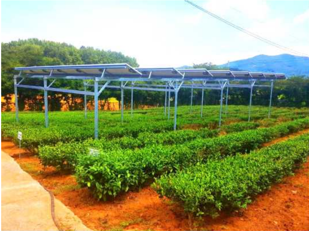
<보성 녹차연구소에서 설치한 영농형 태양광 설비 전경>
