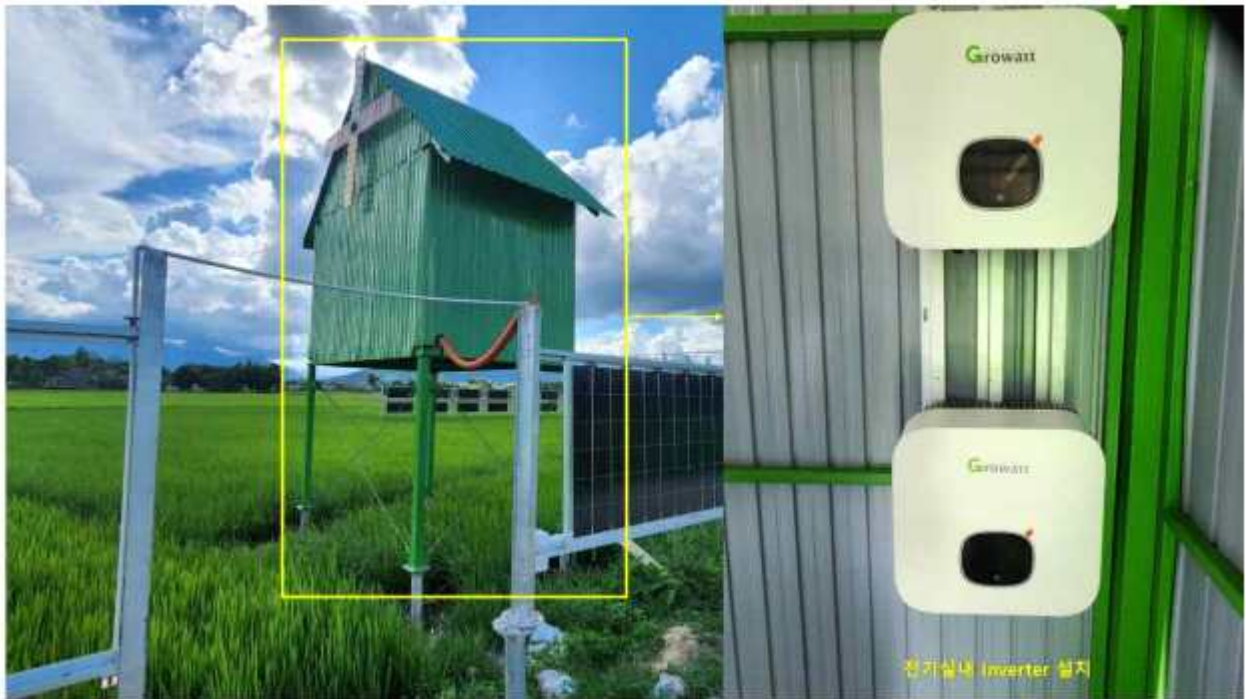
< 무음영 영농형 태양광 발전 설비용 전기실내 인버터 설치 확인 >
