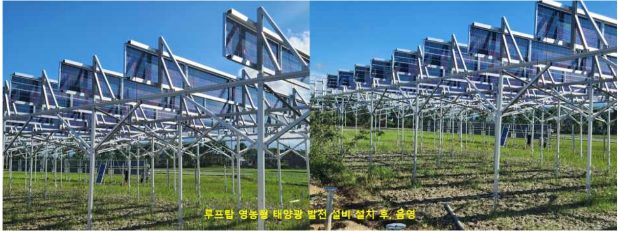
< 루프탑 영농형 태양광 발전 설비 내 음영 >
