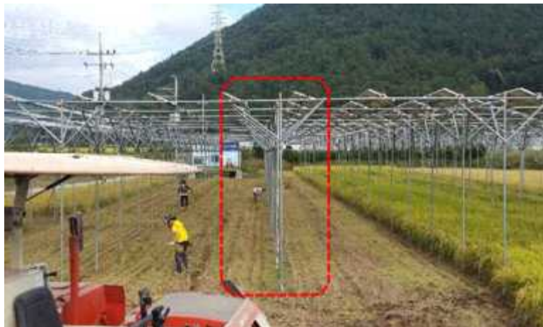
<남동 발전에서 경남고성군에 설치된 영농형 태양광 구조물 전경>
