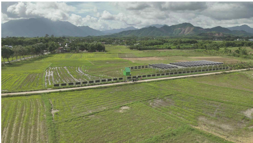
<60kW 무음영 영농형 태양광 발전 설비 >
