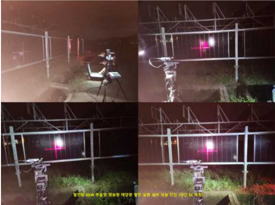
< 무음영 영농형 태양광 모듈 야간 EL 측정 >
