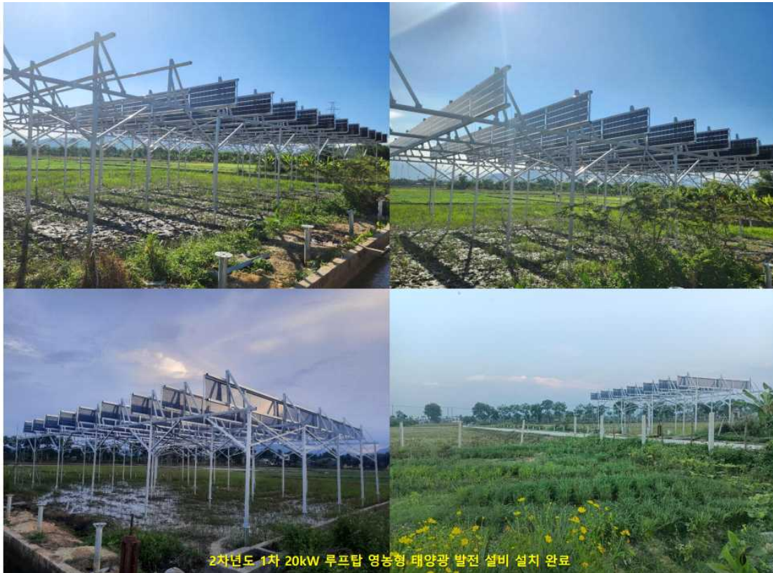
<1차 20kW 루프탑 태양광 발전 설비 >
