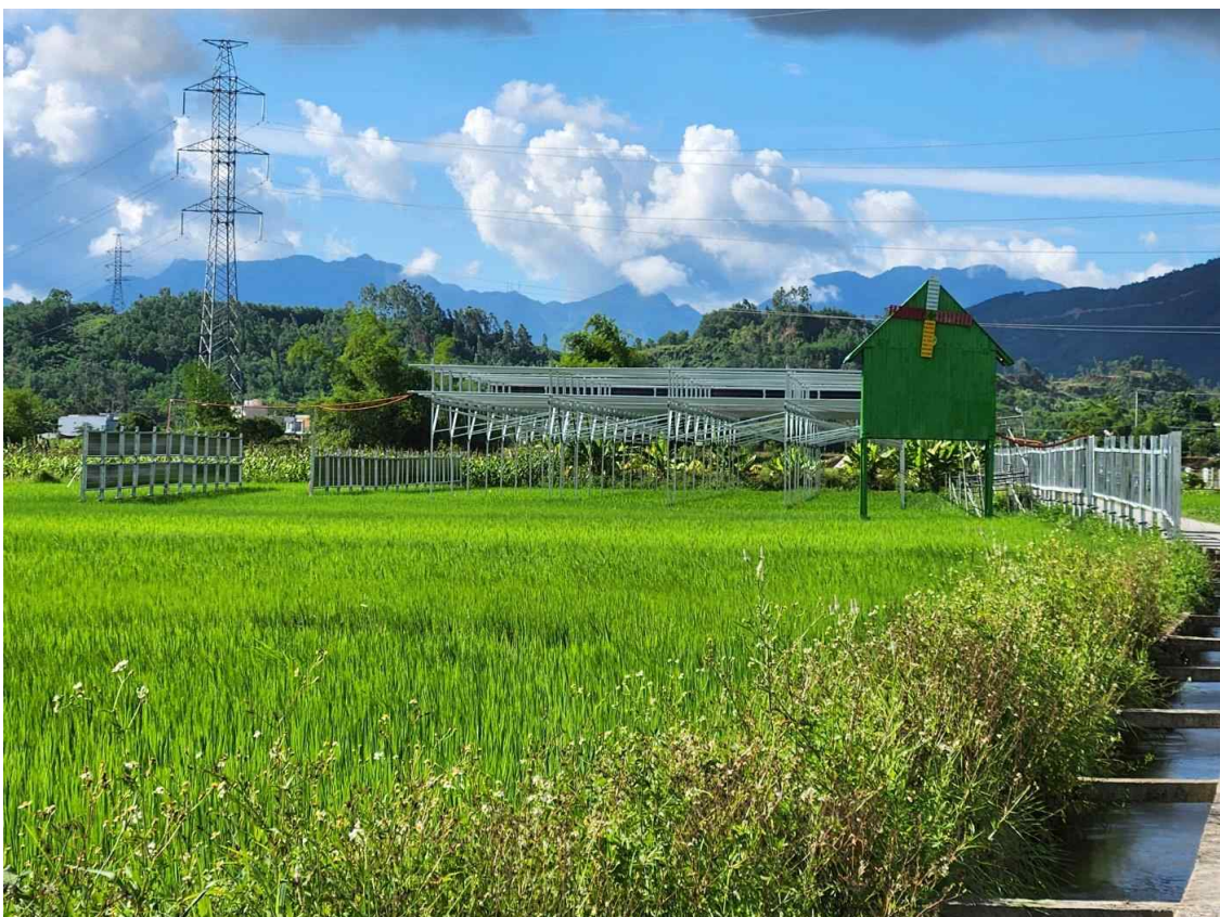
< 무음영 영농형 태양광 발전 설비 실증지 전경 >
