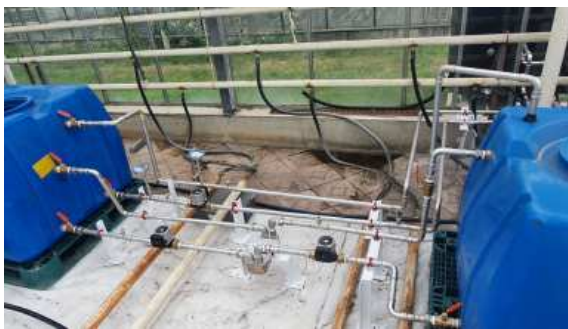
냉난방-양액 탱크 및 배관
