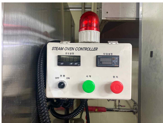
신규 설비 디지털 컨트롤러 및 알람장치
