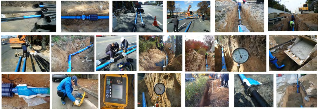
[그림 3-2-2-5] 관 파손 감지 시스템 현장 설치 사진(기아공장 폐수처리장)
