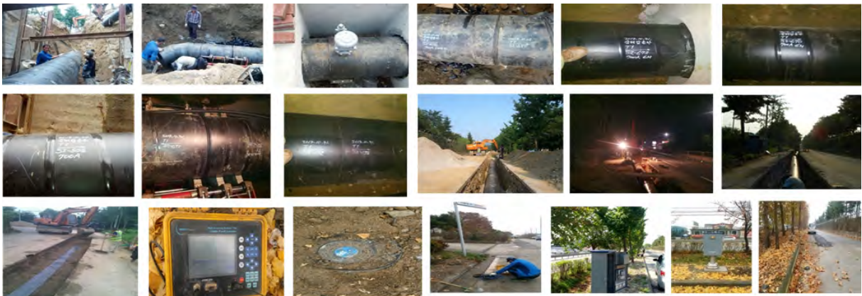
[그림 3-2-2-4] 관 파손 감지 시스템 현장 설치 사진(삼패하수처리장)
