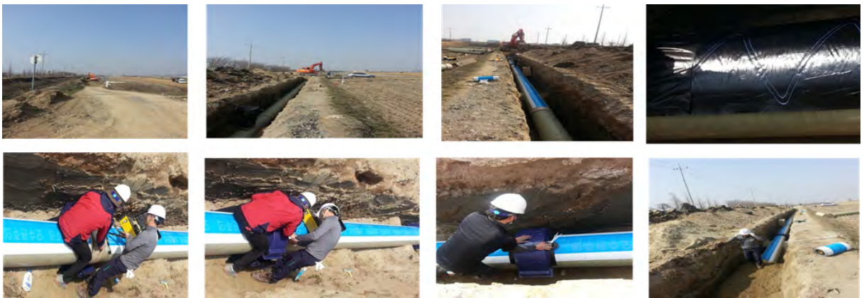
[그림 3-2-2-6] 관 파손 감지 시스템 현장 설치 사진(서산시 재이용수 이송배관)
