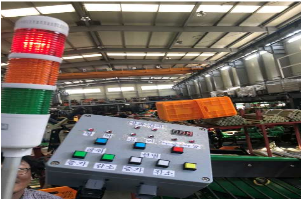
- 배터리 설치 후 정상 동작하는 케이스 내 장착된 전장부 모습 - [ 케이스와 배터리를 통한 개별 성능 실험 ]
