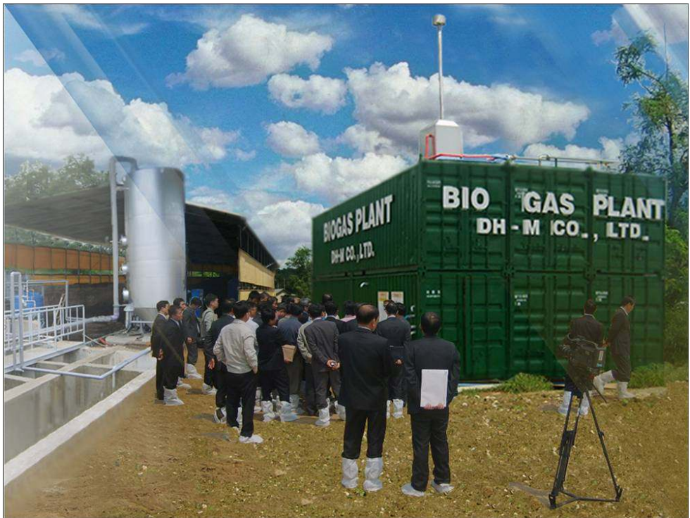
그림 1 본 바이오가스 플랜트 및 정화처리시스템(연구개발 결과물) 돈돈 10톤/일 규모 바이오가스 플랜트(20kw) 및 정화처리시스템 설치 사진 (충청남도 홍성군)
