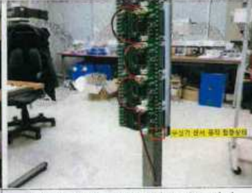
그림 6. 수신기 센서 동작등 점등 상태
