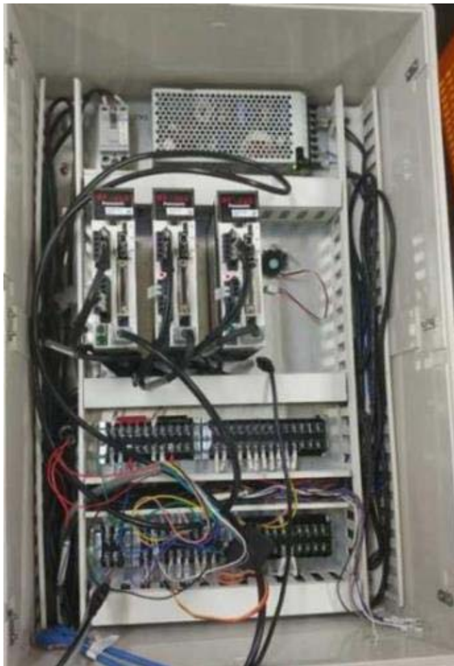
그림 964 An image of control board.
