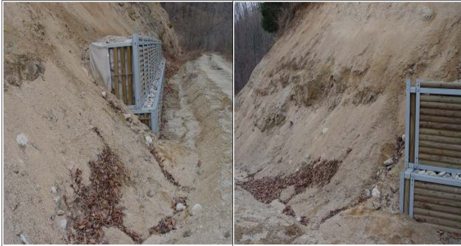
그림 2-27 옹벽 설치구간과 미설치구간 그림 3-28. 옹벽 미설치 구간의 침식
