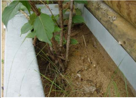
그림 3-46 시공 1년 후 흙 채움 부족
