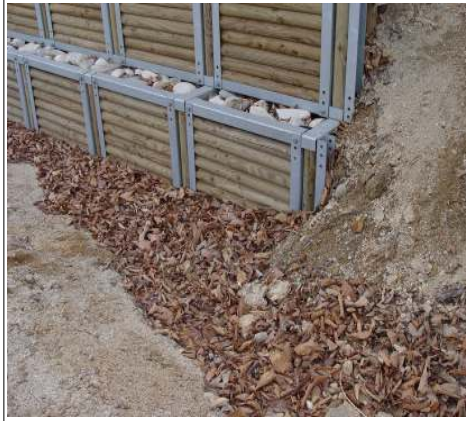
그림 3-23. 옹벽 미설치 구간의 침식
