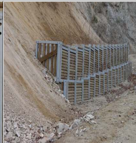
그림 3-36 옹벽 시공구역의 침식상태
