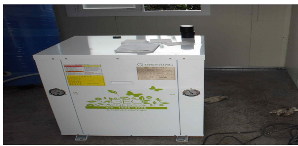
설치된 지열히트펌프 (5RT)
