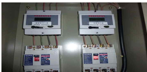
인큐베이터 전력사용량 계측장비
