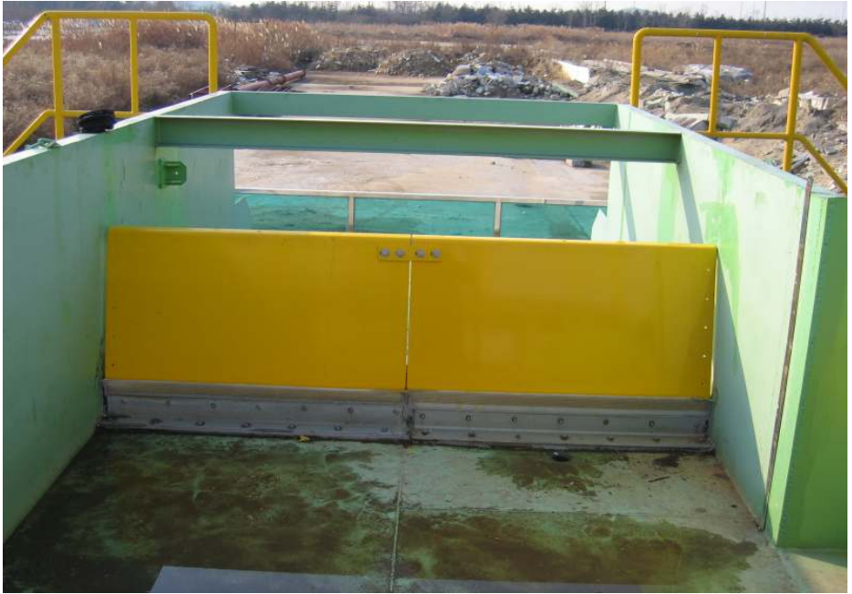
(B) 개량형 무동력 게이트 설치
