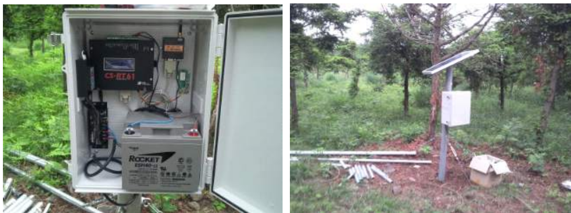
그림 38 외부 보호함 내부 모습 및 전체 전경
