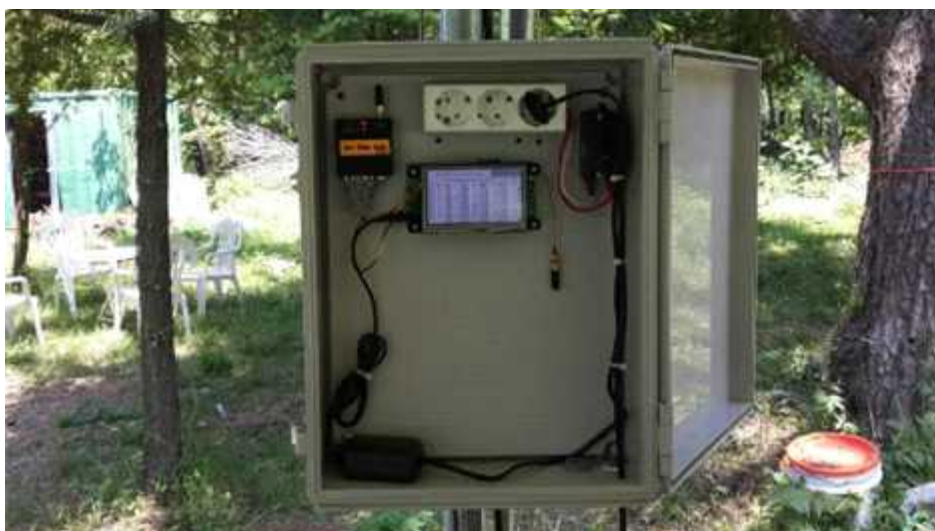
그림 323 외부보호함 내 데이터 수집 전송장치 설치_제주대 양봉장
