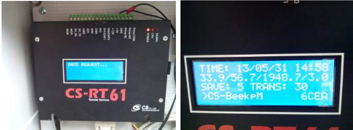
그림 39 전원 공급 테스트 및 센서노드의 데이터 수집 테스트-정상
