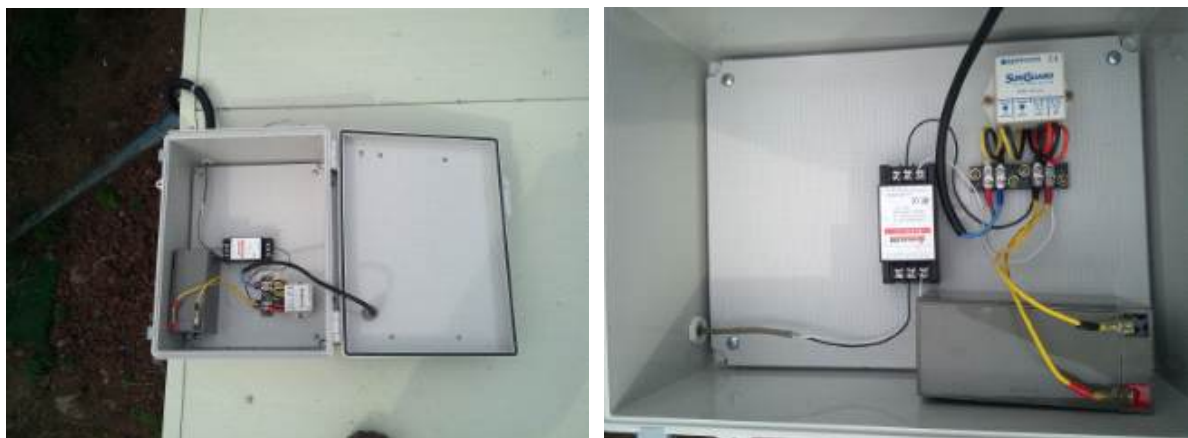
그림 31 설치된 외부 보호함 내부 모습(충전컨트롤러/배터리/써지보호기)
