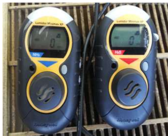
그림 108 좌측이 암모니아, 우측이 황화수소 측정 계측기
