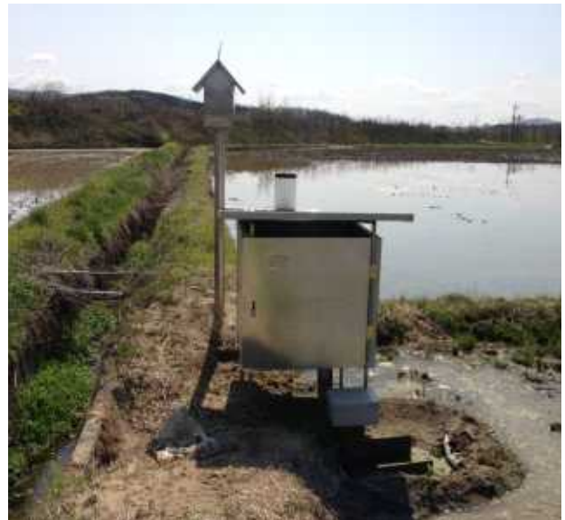
<그림 3-70> PP-02 모니터링 장비 설치 전경
