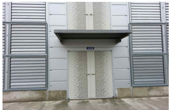
경고판 미부착 축사 출입구(잘못된 예)
