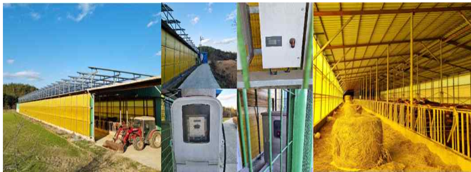
<그림 26> 축사 태양광 설치 및 폐쇄형 지붕
