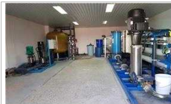
<카타르 염수처리용 설비(RO)>
