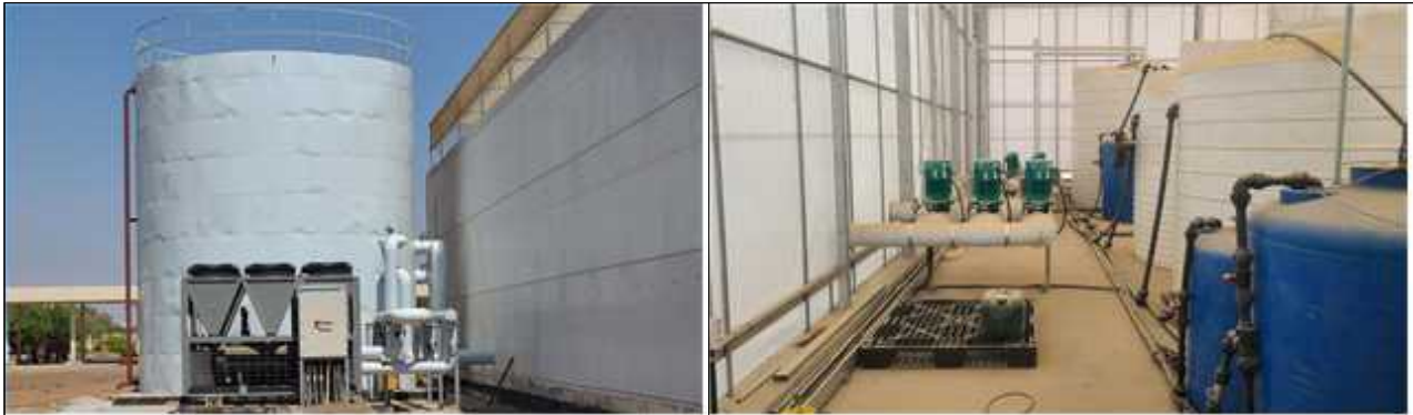
스크류 칠러 및 축열조
