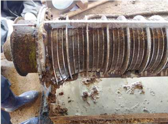
<시험평가 후 스크린 고장 상태_외부상태>
