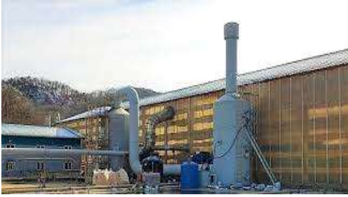
(a) 공동자원화 가축분뇨 바이오가스 시설
