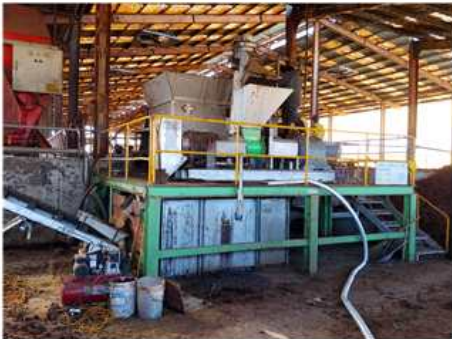
<중형급 탈수기계 현장 설치사진>
