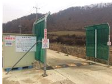
차량용 소독시설 설치 및 운용
