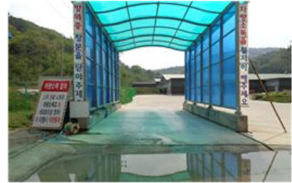
[농장 정문에 설치된 차량용 소독시설]
