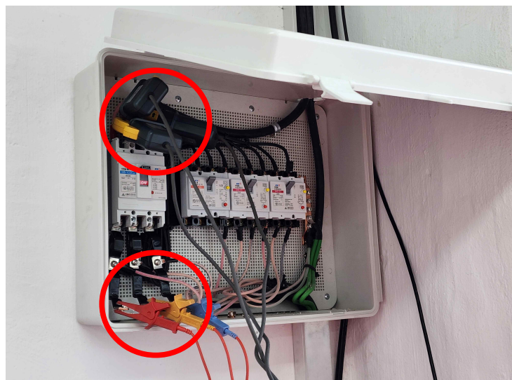
그림 108 전력 소모량 측정 계측 장비 연결
