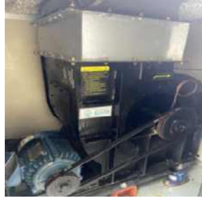
Fig 4. Fan in air handling unit
