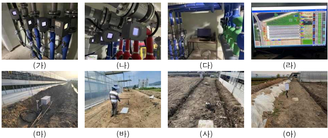
그림 2-5-3-7. 모니터링장비 설치 : (가) 기계실 양수관 전자식 유량계 및 온도센서 설치, (나) 기계실 환수관 전자식 유량계 및 온도센서 설치, (다) 데이터 통신 및 저장장치, (라) 모니터링 화면, (마) 유량계보호통 설치, (바) 보조주입정 온도센서 설치, (사) 온도센서 설치 완료, (아) 지열공 모니터링 패널 설치완료
