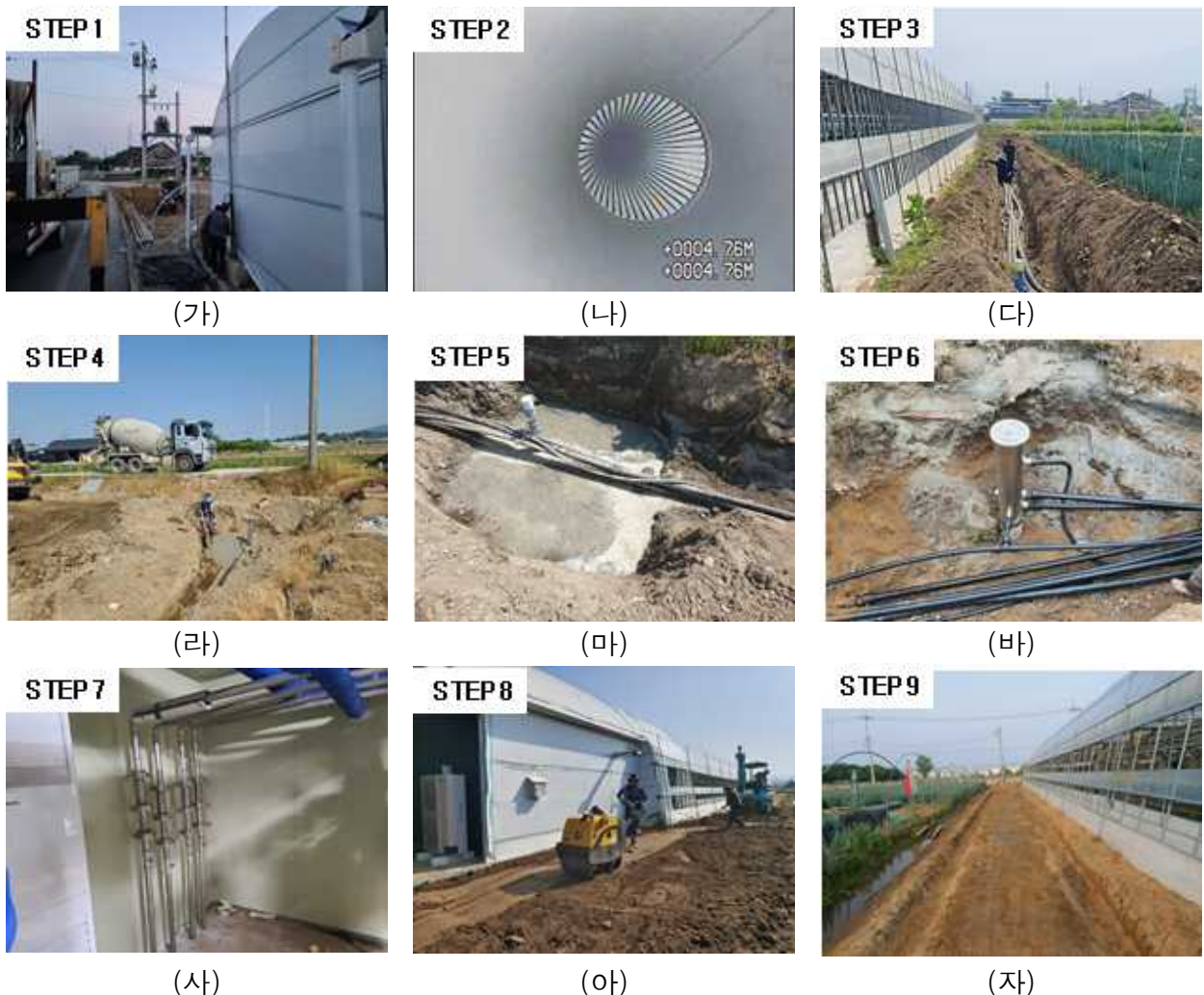
그림 2-5-3-5. 지열정 보강공사 : (가) 양수시설인양, (나)지열공 CCTV촬영, (다) 트렌치배관 교체,(라) 지열공 보강공사, (마) 보조주입정 보강공사, (바) 완전밀폐형 상부 보호캡 설치, (사) 기계실 배관 교체, (아) 부지 다짐공사, (자) 부지정리 완료
