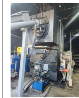
목재칩-농업부산물 혼소보일러 설치사진
