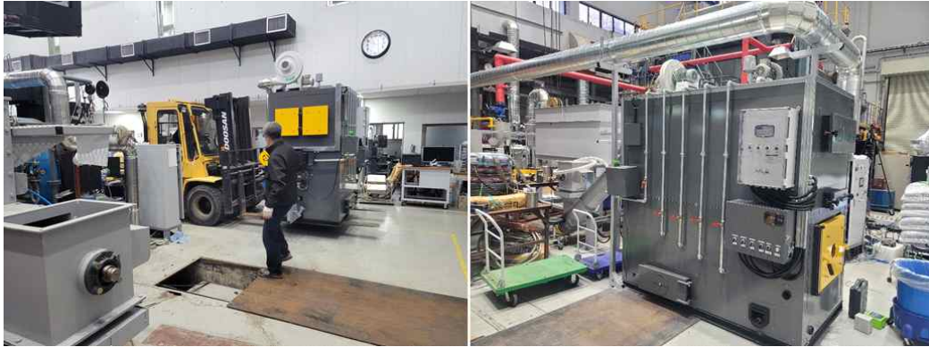
[그림 374] 우드칩 보일러 설치
