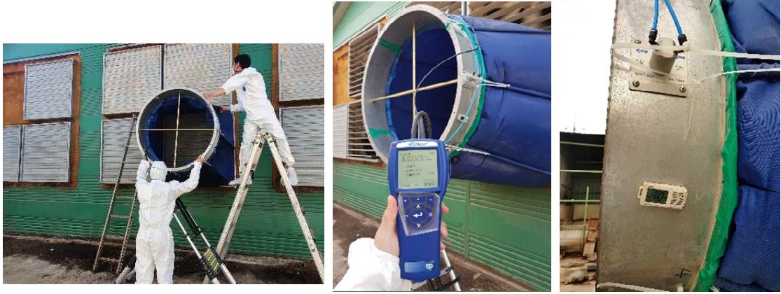
(a) 계사 터널배기팬에 풍량계 설치하는 모습
