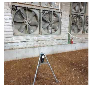
(c) 배기팬 내부 정압 측정
