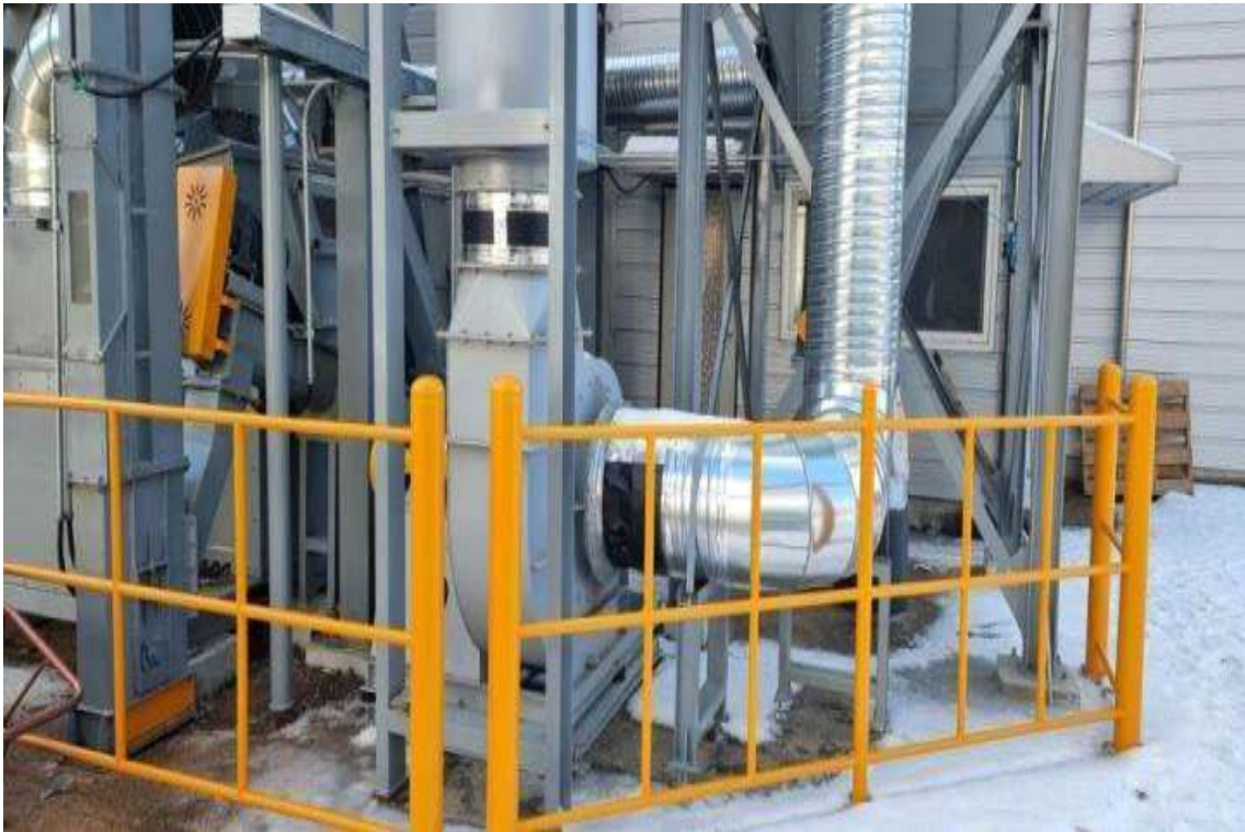
그림 118. 블로워 설치 사진.
