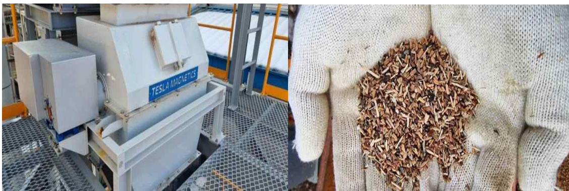
그림 105. 자력선별장치 설치사진 및 철 폐기물 사진.
