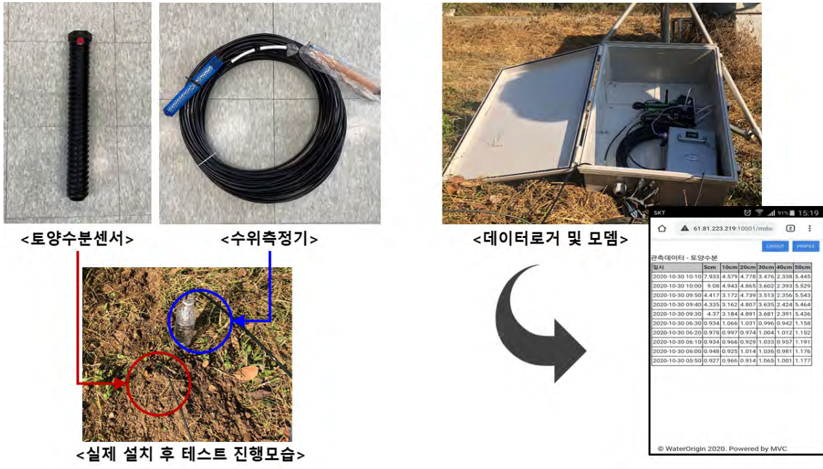
[그림 5-14] 대상지 설치 및 데이터 수신 확인
