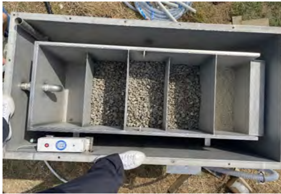
내부 수처리 시설
