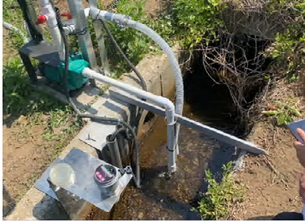
지표수 용수공급 펌프 ON
