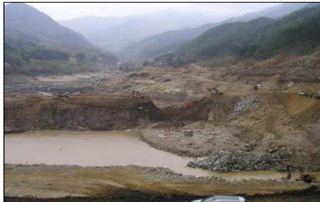
[그림 2-4] 가물막이(토제) 붕괴 사고 전경
