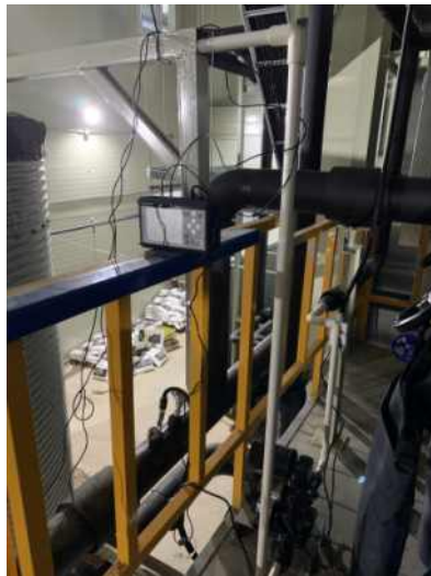
[그림 3-32. 포터블유량계 설치 사진]
