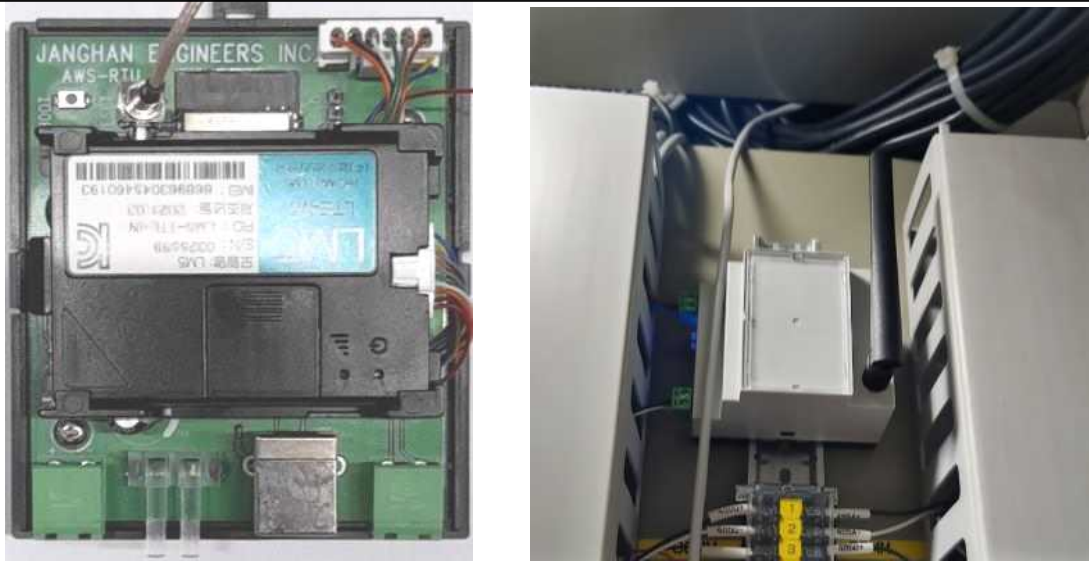
[그림 3-52. RTU 모듈 내부 및 RTU 설치 사진]
