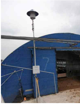
<그림 27. 부안 1 오리농장에 설치된 침입방지장치>
