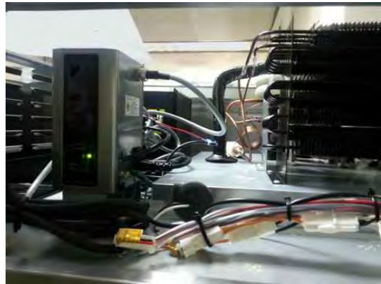
<습압용 트랜지스터 및 컨트롤러>
