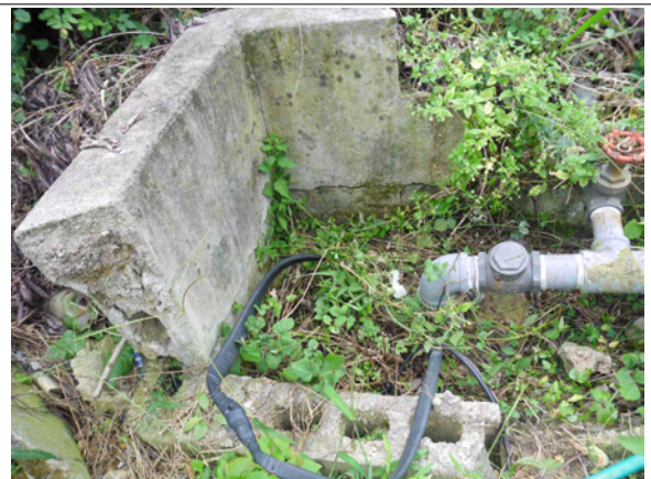
사 진 (보호공 파손)
