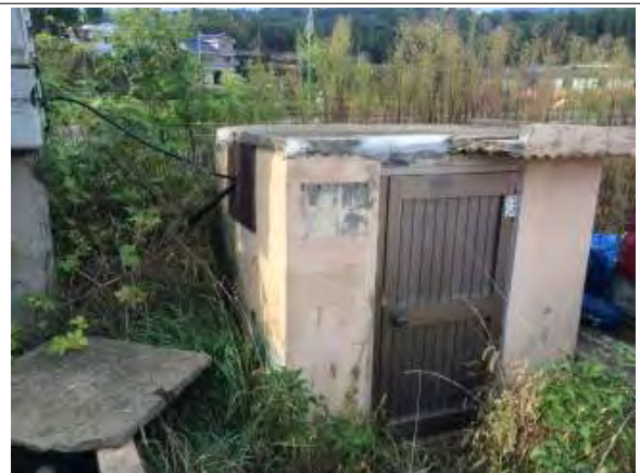
사 진 (양수장 파손)
