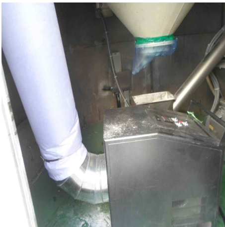
사일로 내부에 설치된 열풍기
