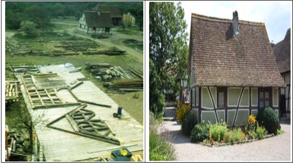
<그림 4-19> 알자스 전통 가옥 중 하나인 Koetzingue 주택 해체, 이전 복원 및 재조립을 위한 작업과정과 완성된 모습(1980년)
