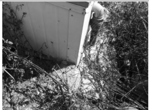
사 진 (보호공 파손)
