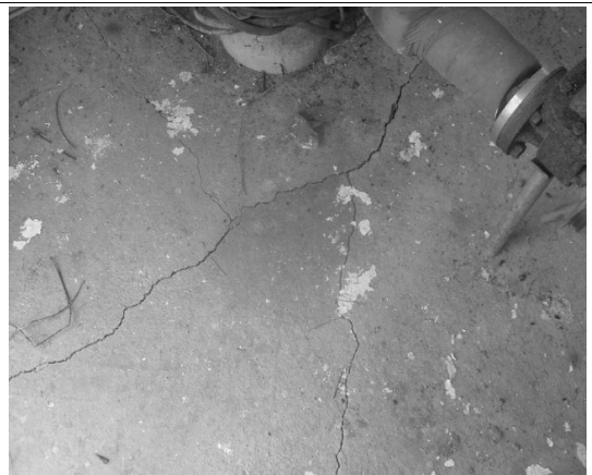
사 진 (바닥 균열)
