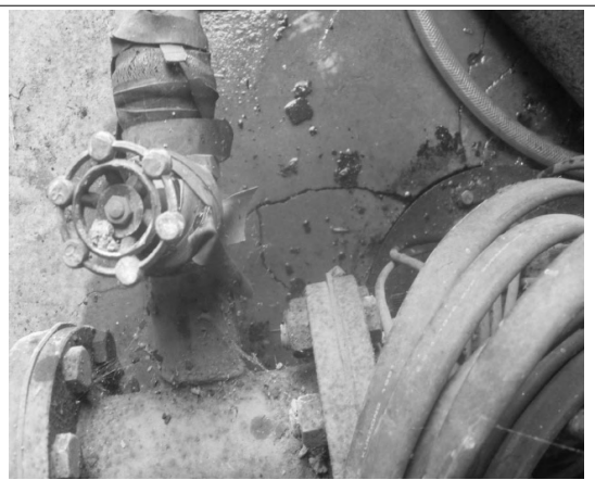
사 진 (내부 균열)
