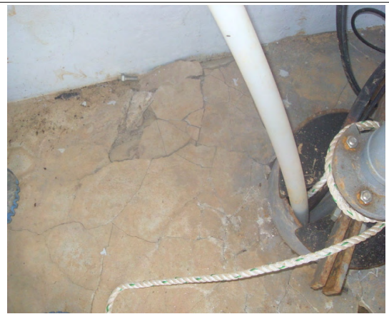
사 진 (바닥 균열)
