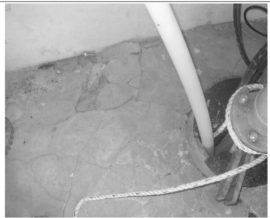
사 진 (바닥 균열)
