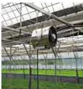
시설 내 습도 조절을 위한 제습기 설치
