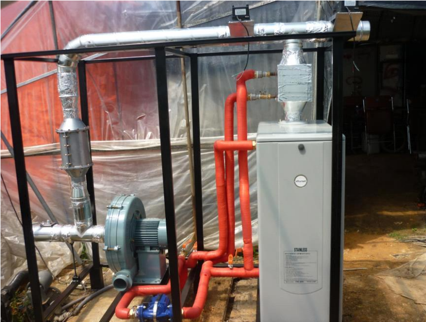
Fig. 2-49. 온실 내부에 설치된 CO 2 발생 시스템
