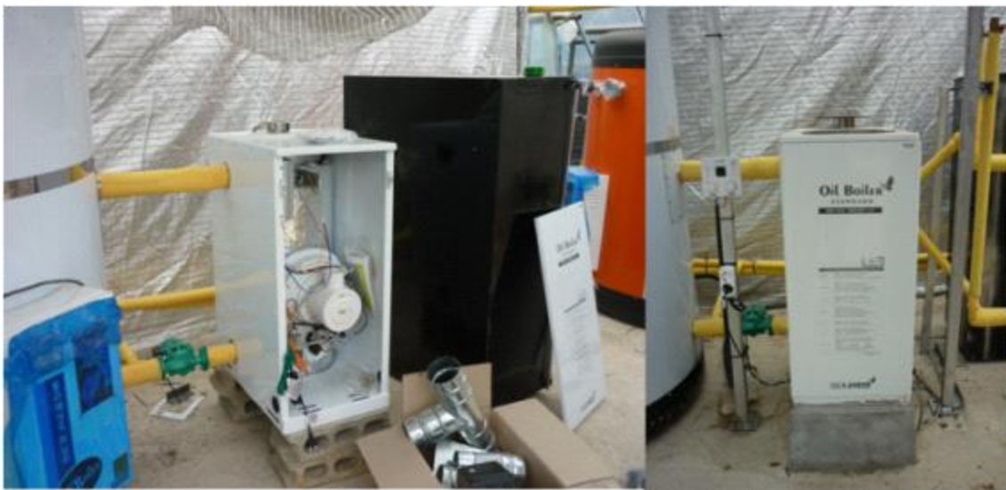
Fig. 1-28. 보일러 설치 현황
