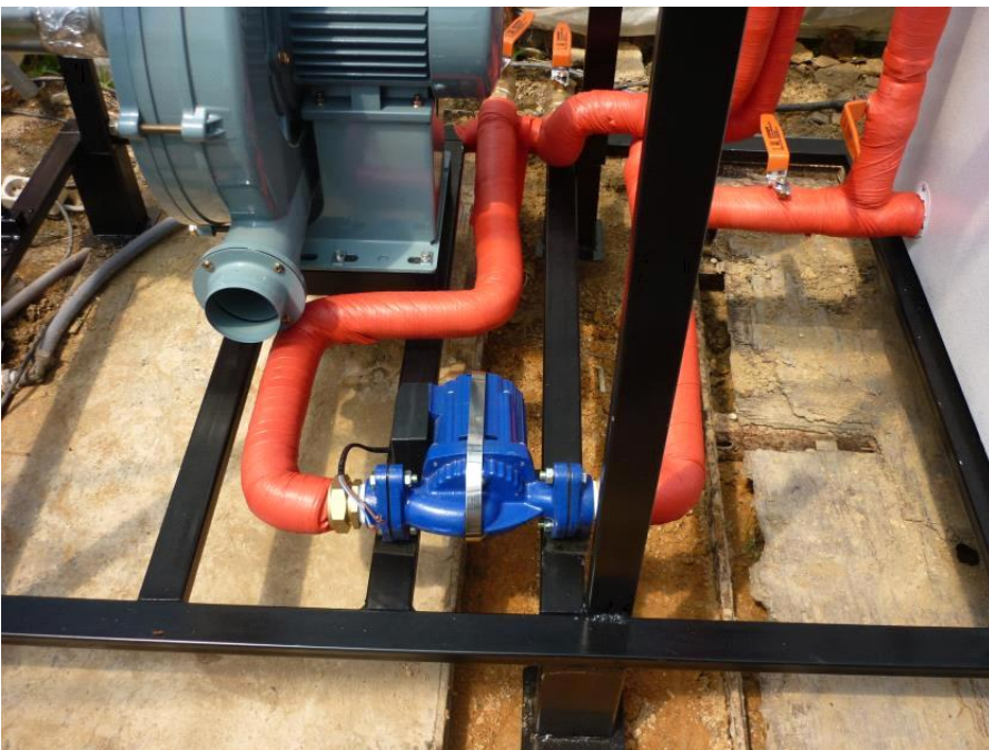
Fig. 2-54. 보일러 온수 순환펌프
