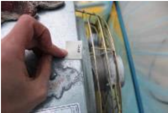
Fig. 2-34. 팬코일유닛 송풍구 온도 측정용 열전대(CH 20)
