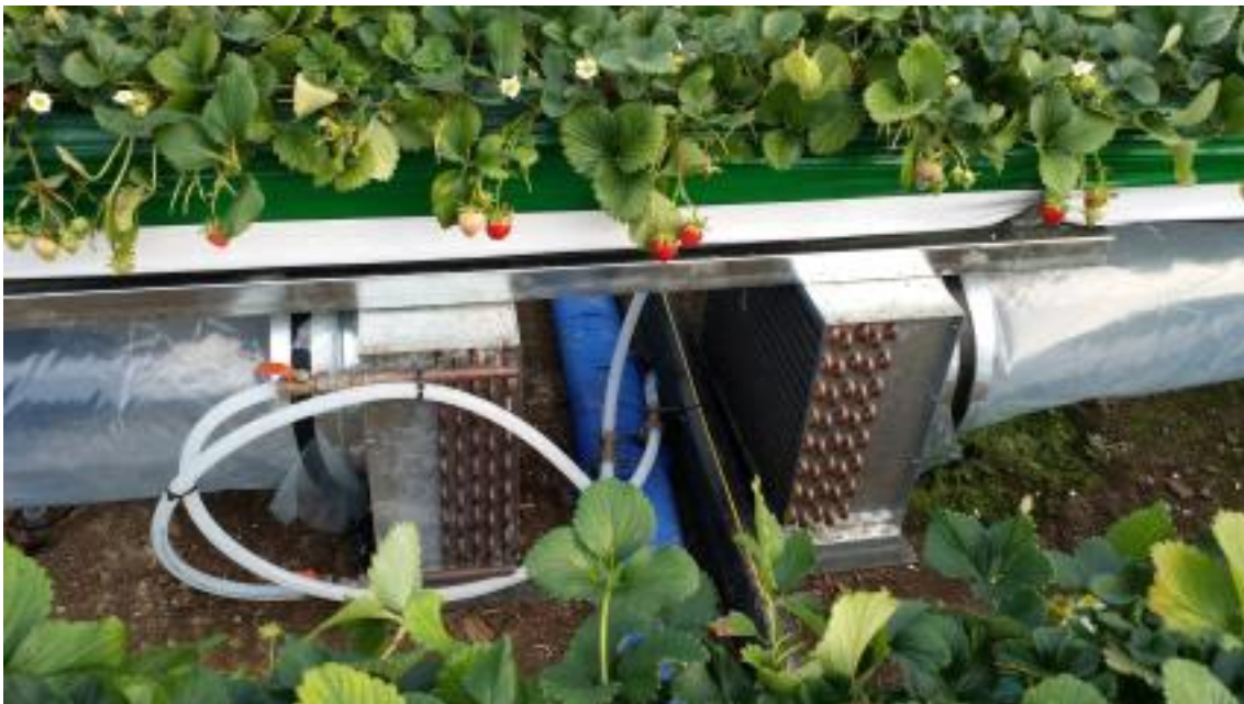
Fig. 3-38. 딸기 수경베드 하부에 설치된 팬코일 유닛 및 송풍장치
