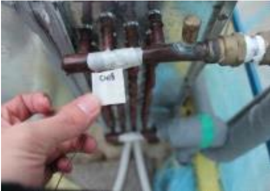
Fig. 2-32. 팬코일 유닛 온수출구 온도 측정용 열전대(CH 18)
