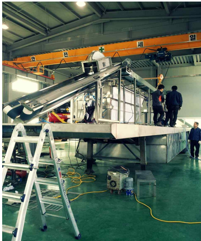
그림 63. 염수회수조, 절임조 및 이절기 설치
