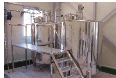
그림 3-48 이중재킷의 냉각장치와 교반기가 설치된 밀폐식 제성탱크
