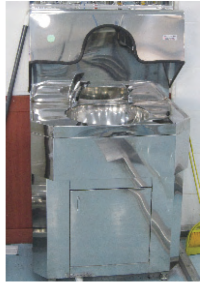
그림 3-32 출입구에 설치한 손 세척기
