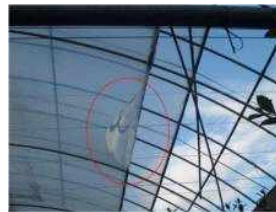
2층 구조물 물고임
