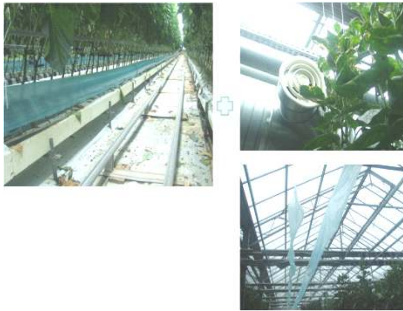
[그림 3-I-16] Photos of air duct facility of B greenhouse.
