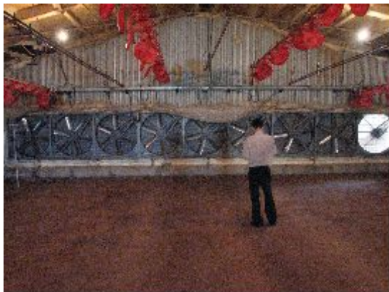
Fig. 3.2.3. 터널식 배기팬 전경
