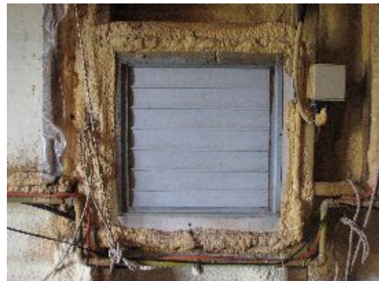
Fig. 3.2.4. 측벽에 설치된 크로스 배기팬
