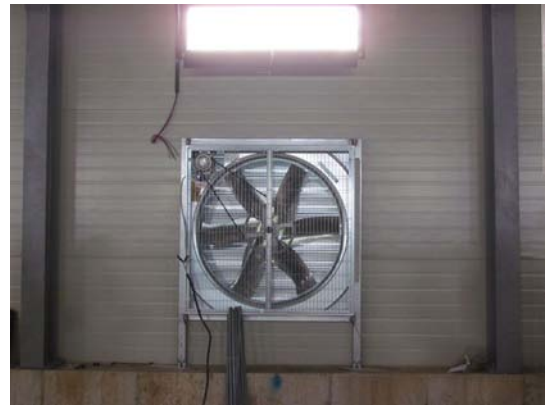
(d) 설치된 배기팬 모습
